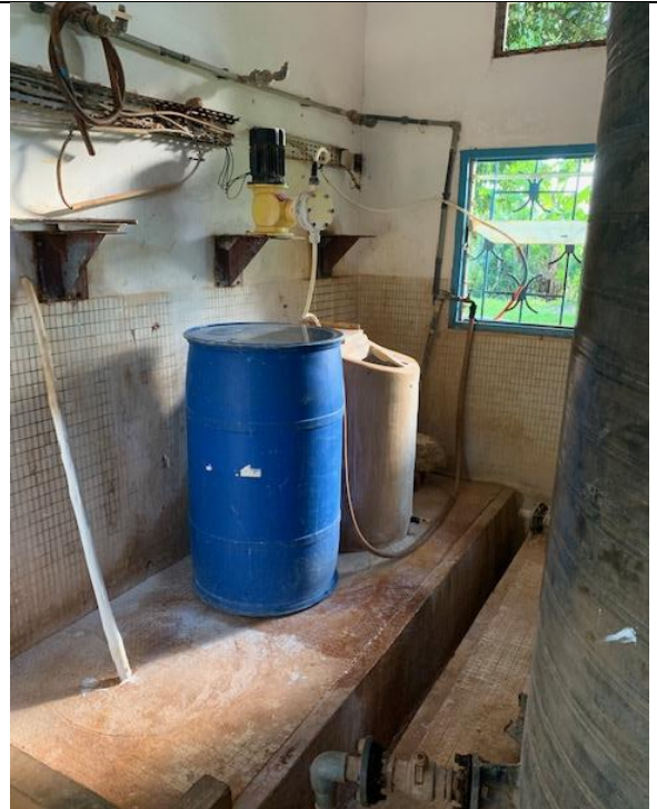
Salle préparation dosage Chlore
