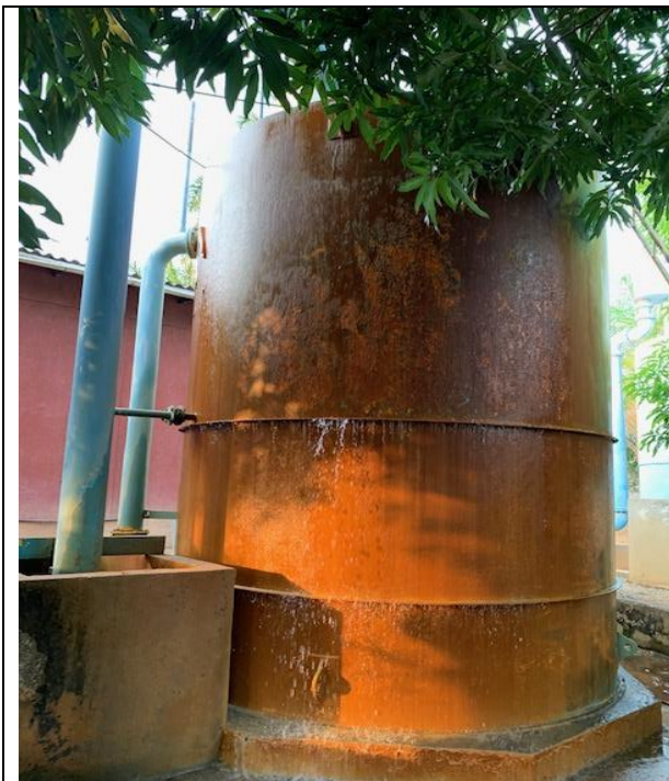
Cuve envoi réseau (mauvais état/rouillée/fuites)
