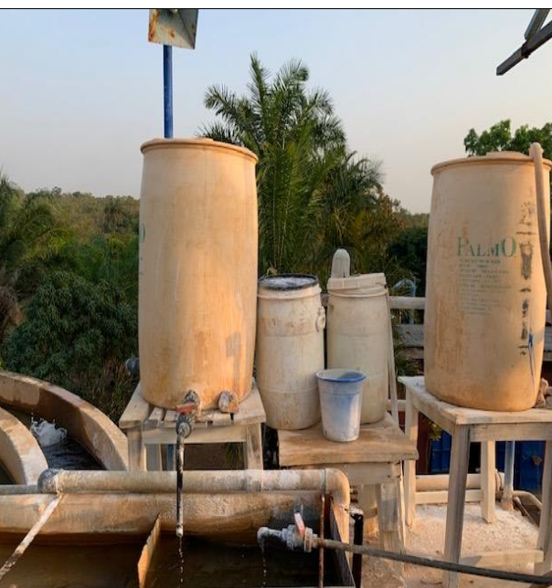
Cuve solution chlorée
