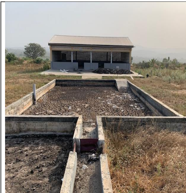
GBV – Lit de séchage boues de vidange
