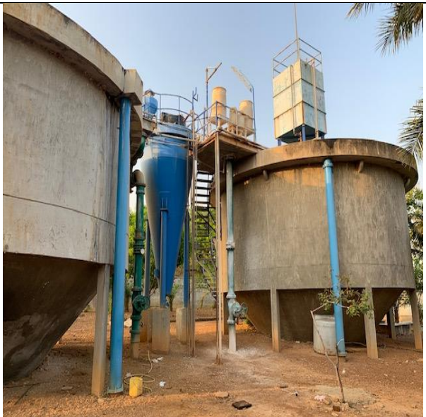
Cuves de potabilisation / Chloration
