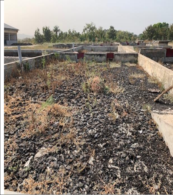
Lit de séchage des boues de vidange
