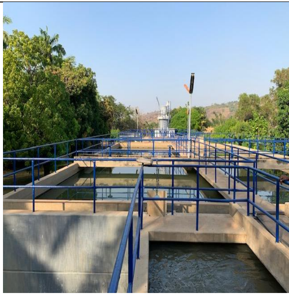
Vue bassins circuit traitement eau STEP (coagulation-floculation, décantation et filtration)
