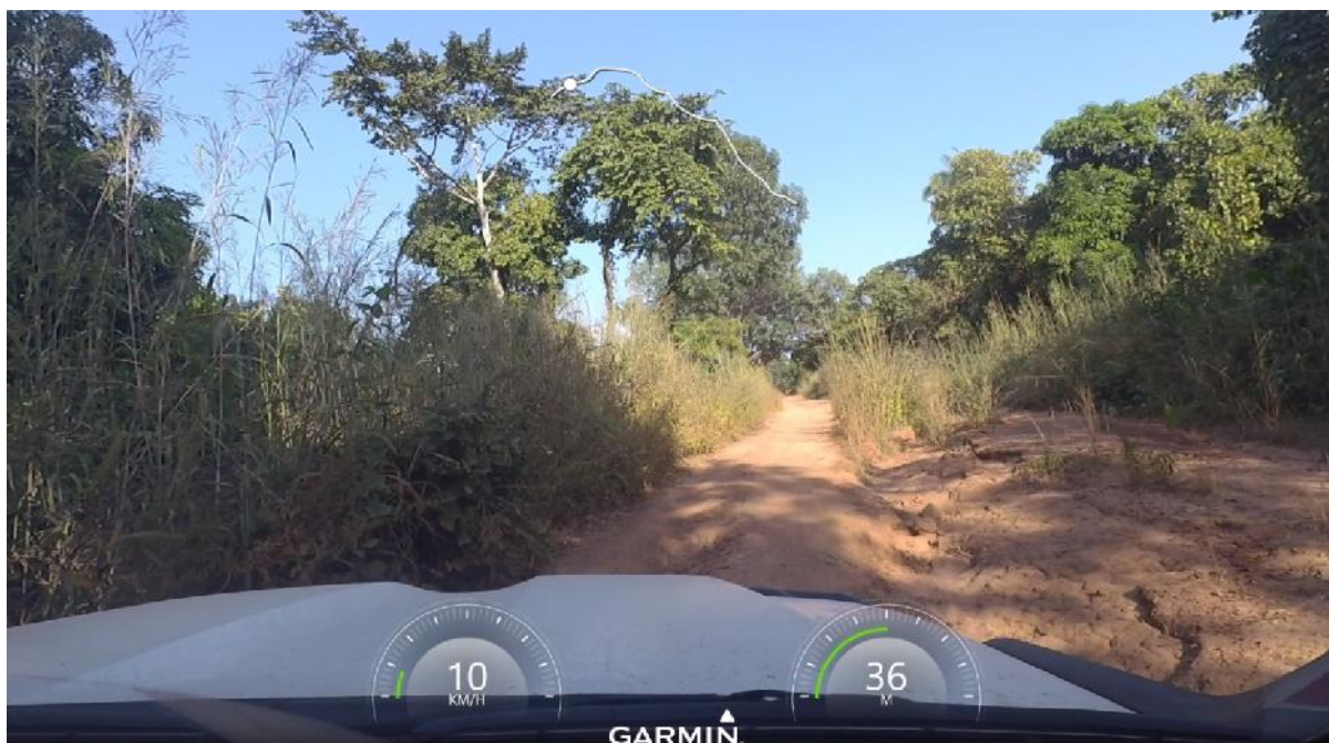
Section non améliorée sur la section Nova Sintra - Buba. Cette section est à améliorer sous le nouveau programme landa-Estradas. A noter le mauvais état de la route : la vitesse tombe à 10 km/h
