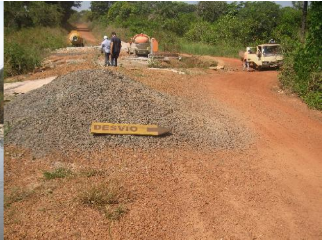
Travaux en cours sur dalot triple. A noter la signalisation de déviation insuffisante
