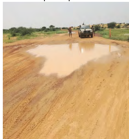
PK21- Accumulation d'eau par absence d'ouvrage
