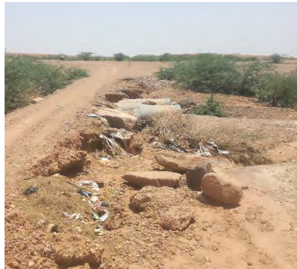
PK0,2- Passage de 3 buses endommagé- Capacité insuffisante
