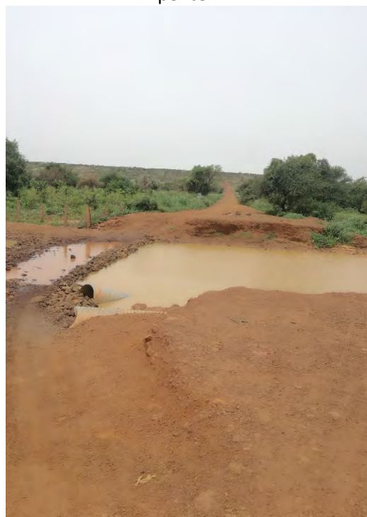
PK7- Digue emportée par manque de section mouillée suffisante pour le passage du khori
