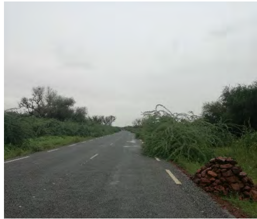
PK13+800- Envahissement par la végétation (visibilité réduite)
