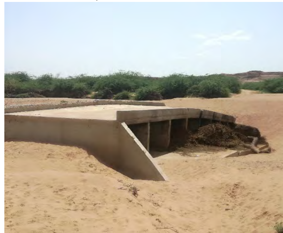
PK2,2- Dalot multiple endommagé et remblai d'accès emporté
