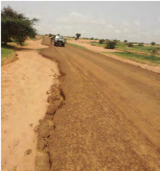
PK52,3- Erosion de la plateforme- Kori longeant la route
