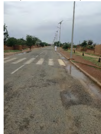
PK75+800- village Tounfalis-Mauvais drainage
