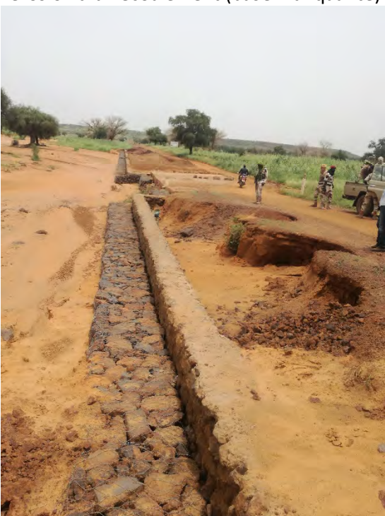
PK 11,4- Erosion de la plateforme et coupures fréquentes par débordement d'un khori qui longe la route (travaux de réparation en cours)
