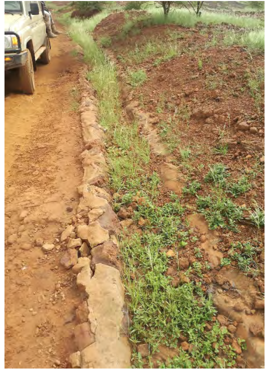
PK 21- Fossé maçonné endommagé et colmaté (absence d'entretien)
