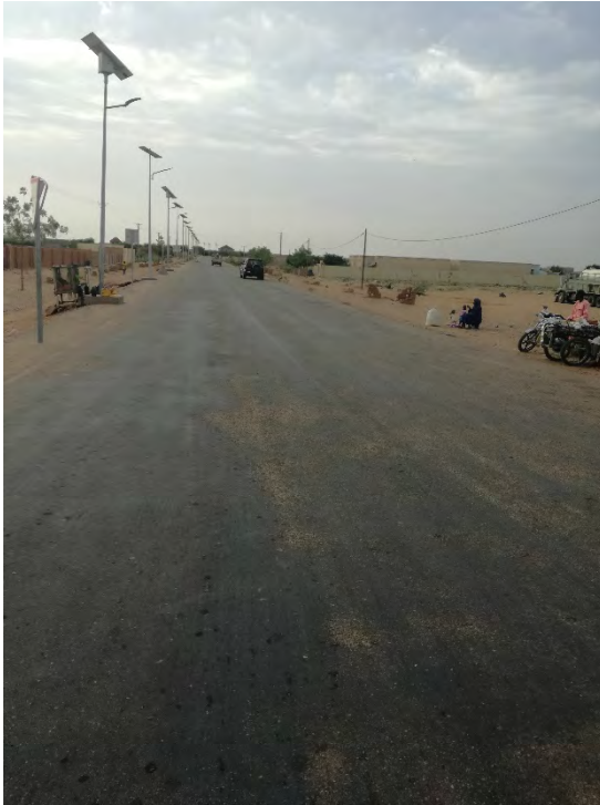
PK0- Début du projet – revêtement bicouche de faible qualité sur les 3 premiers km
