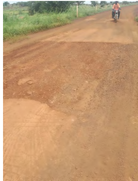
PK 15- Dalle de radier arrachée
