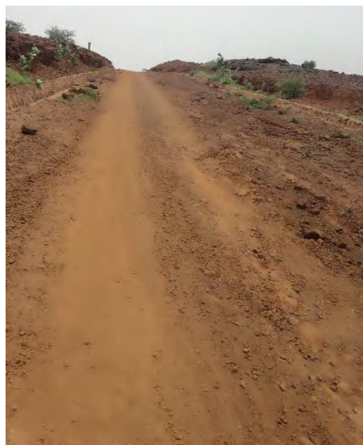
PK 12,4-Ravinement prononcé en zone de pente
