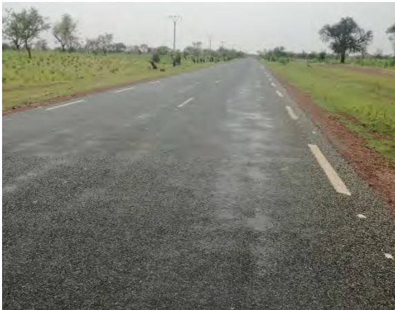
PK1+600 – Stagnation sur la chaussée due à l'ornièrage
