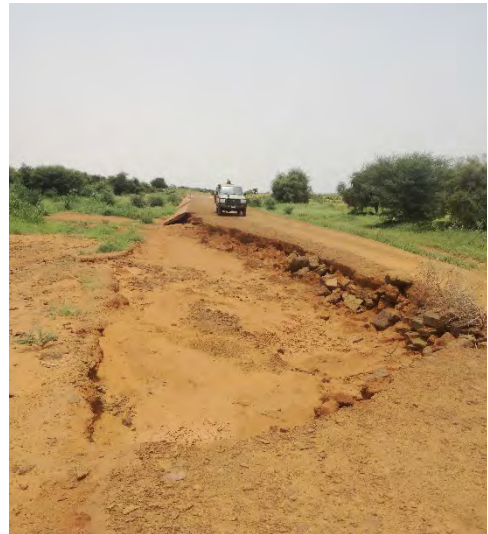
PK34,4- Plateforme érodée par manque de protection
