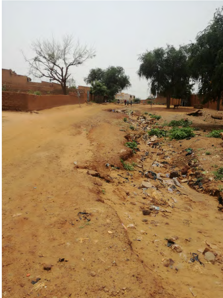
PK0,4- ville de Tahoua- Ravinement par absence de drainage
