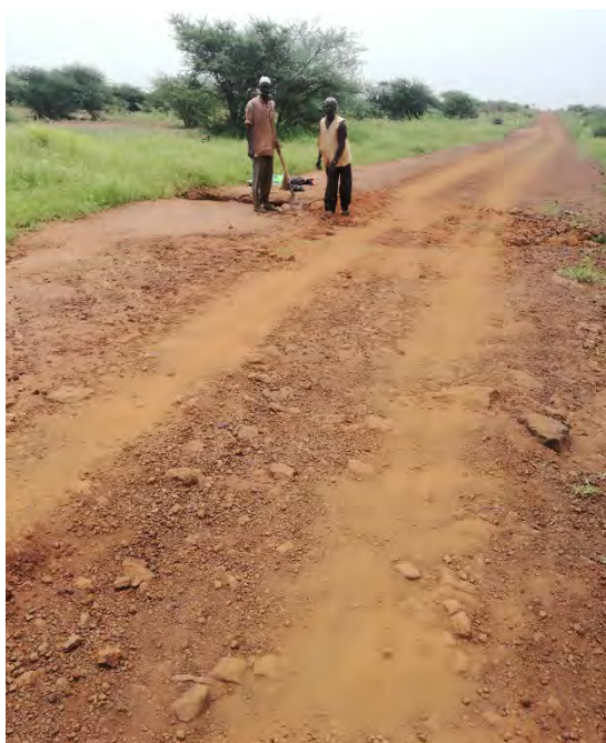
PK 13,4- Réparation par des villageois d'une érosion d'un écoulement (buse manquante)
