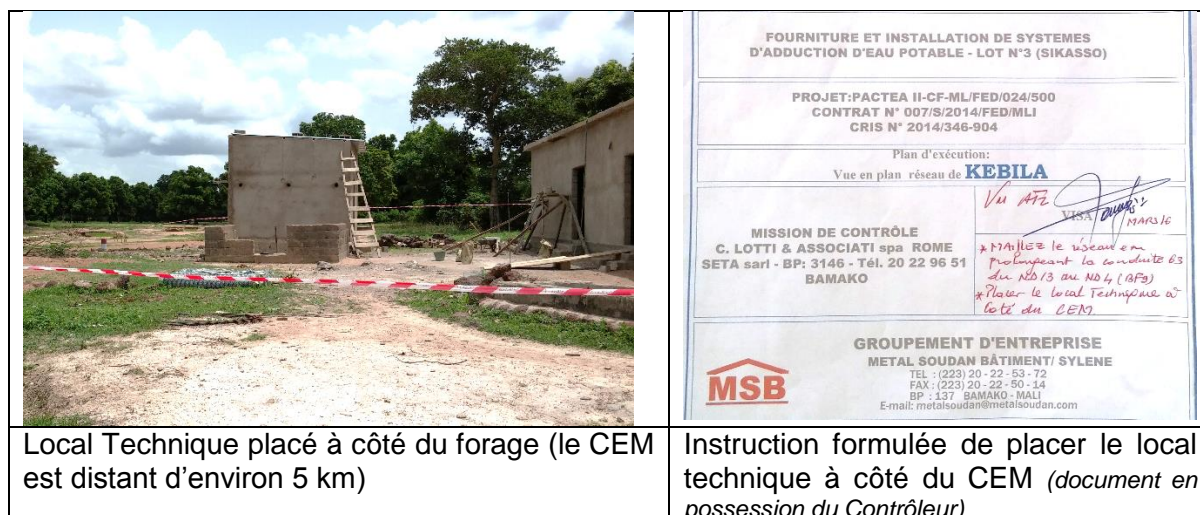
Figure 2 : Exemple d'instruction tardive de l'AT non respectée sur le chantier (Kébila)
